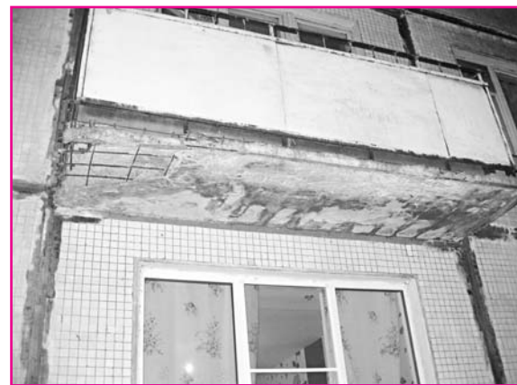
ул. Ленинградская, дом 15. Такой балкон опасен
